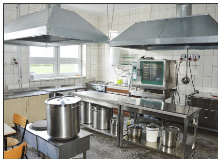
Kuchnia w ZSP w Czerniewicach przed remontem
