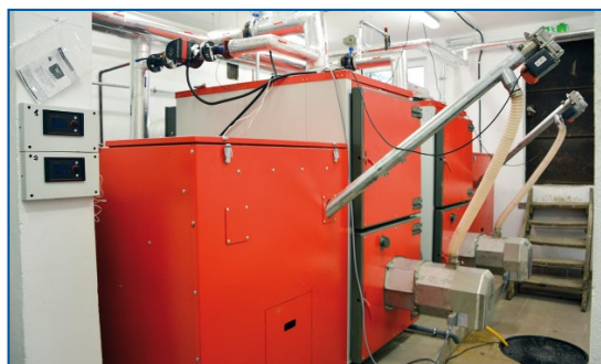
Nowy piec centralnego ogrzewania; poprzedni, pochodzący z połowy lat 90. ubiegłego wieku, był już niewydajny
